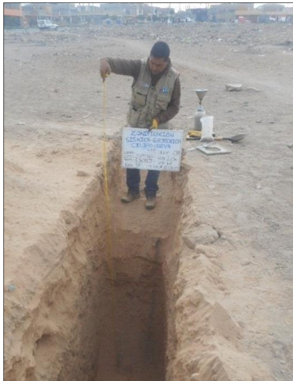
Figura 25: Ejemplo de “Calicata CAA-08” ubicada en el área de redes de alta tensión de Alto de la Alianza.
