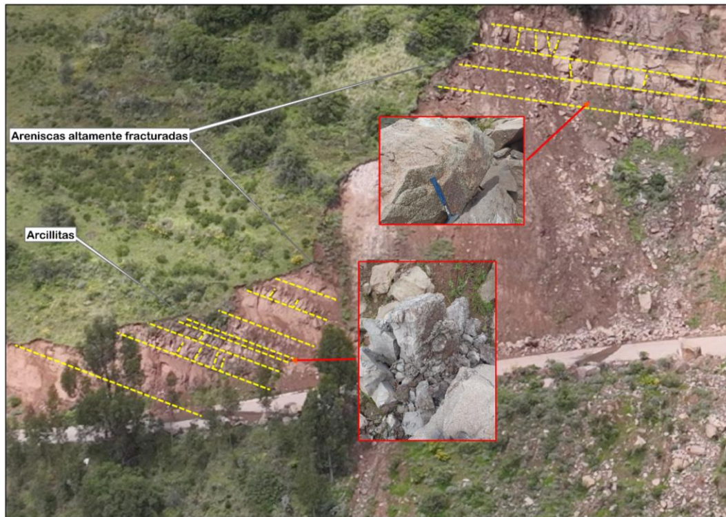
Figura 20.- Areniscas altamente fracturadas que condicionan la caída de materiales a favor de la pendiente.
