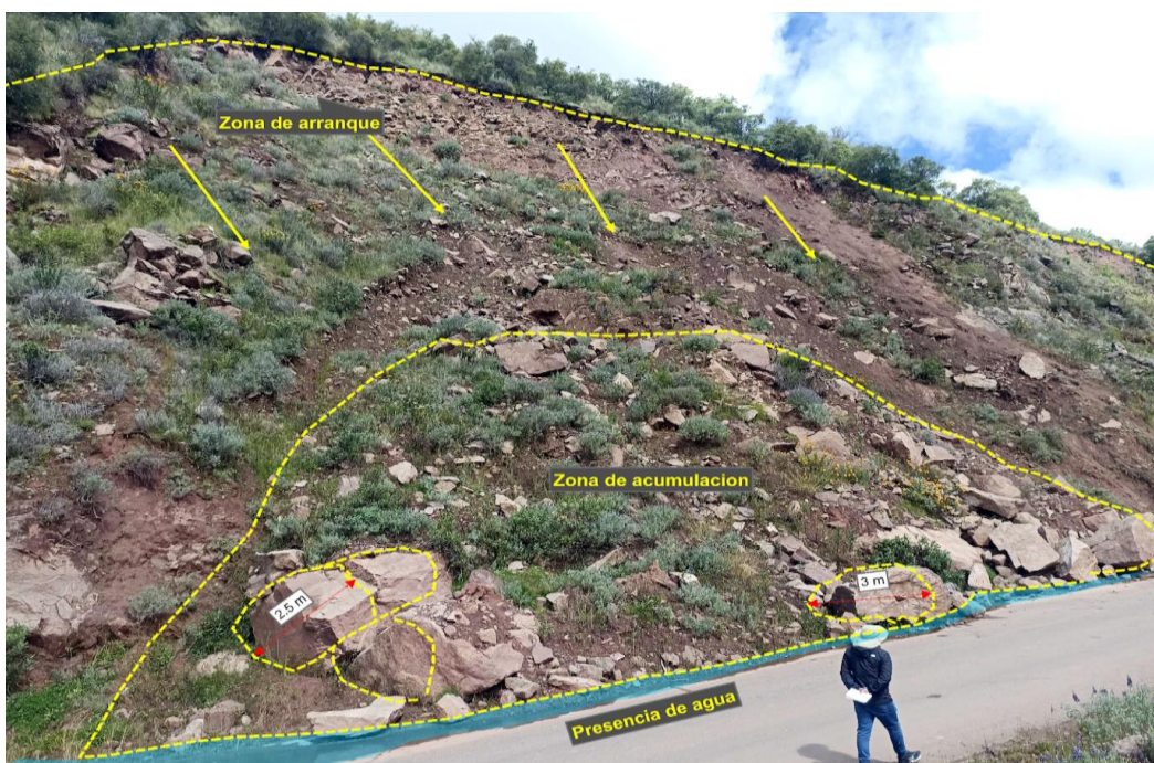
Figura 28.-Derrumbes identificados en el sector Kumurumuy, la caída de materiales afecta la seguridad física de la carretera de la vía Cu-117 en Paruro
