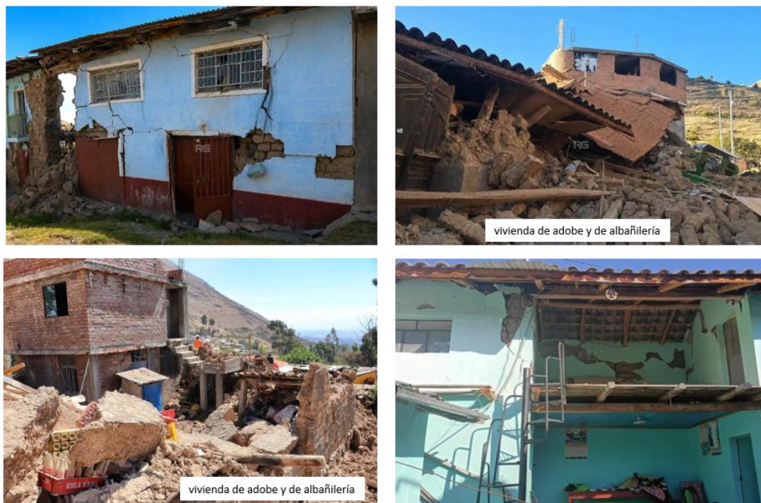
Figura 9.- Diversos tipos de daños en viviendas de adobe en comparación con viviendas de ladrillo y concreto que no presentan daños (Fuente: diversos medios de comunicación)
