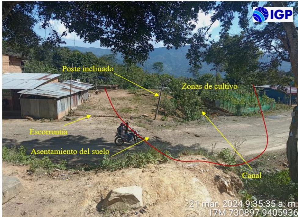
Figura 36.- Deslizamiento en la parte baja de la I.E. N° 17649, alrededor se observa como evidencias poste inclinado, asentamiento y grieta en suelo, además, zonas de escorrentía y canal de agua que saturan el suelo
