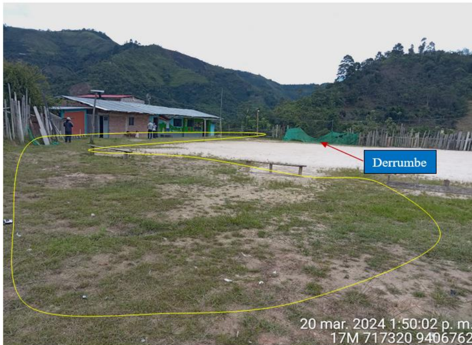
Figura 32.- Patio de la I.E.I N° 1238 susceptible a inundación pluvial (polígono amarillo) debido a la deficiencia de drenaje pluvial
