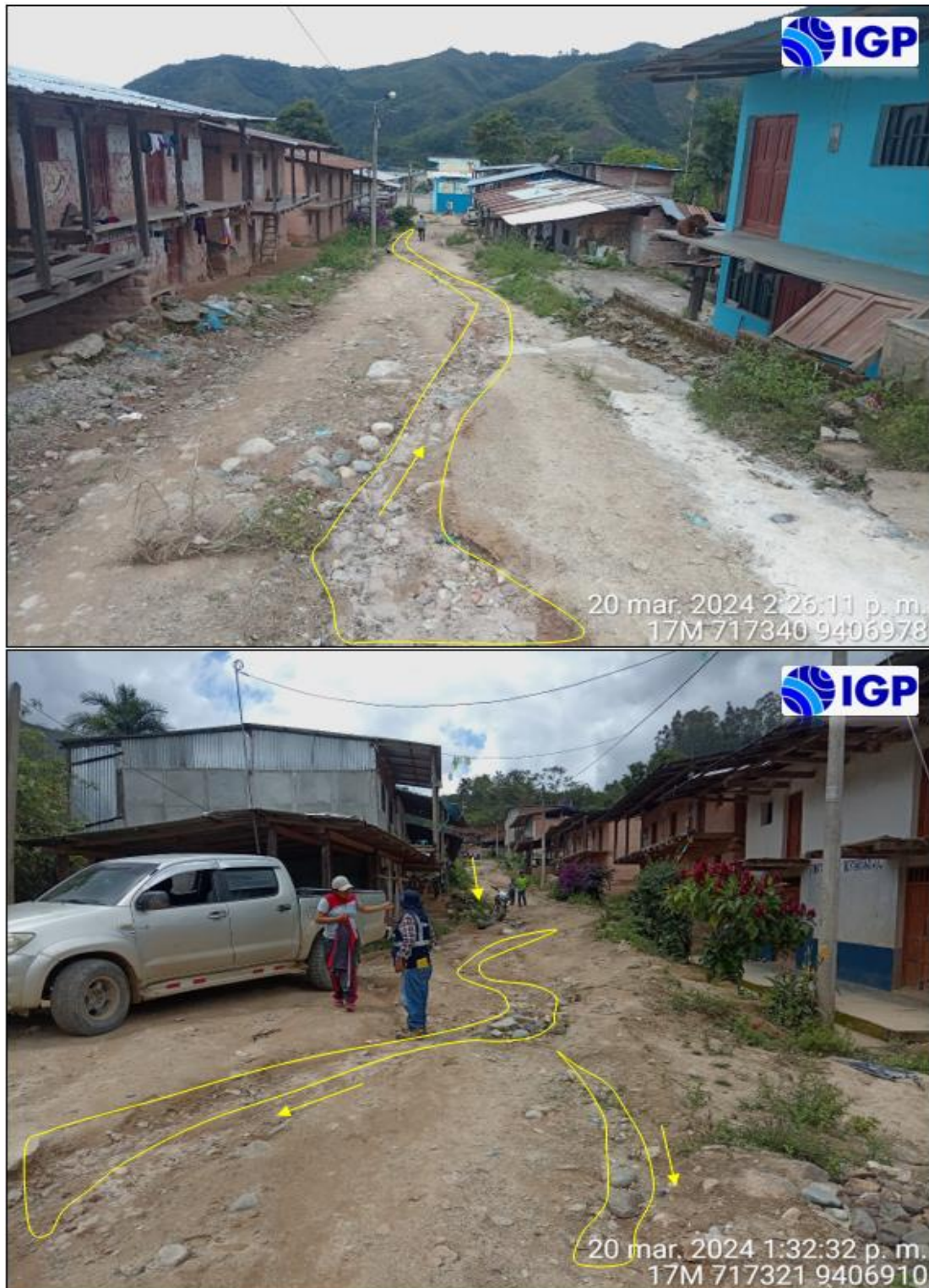
Figura 30.- La calle de ingreso principal a la I.E. Primaria 16761 Monterrico presenta cárcavas generadas por la erosión de laderas (polígonos amarillos) debido a la presencia de escorrentía pluvial durante la ocurrencia de precipitaciones pluviales intensas.
