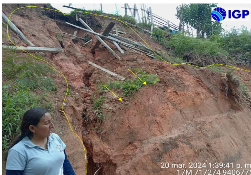
Figura 28.- Derrumbe identificado en la parte baja de la institución educativa inicial N° 1238 debido a presencia de agua de escorrentía sobre talud diseñado para apertura de vía de acceso
