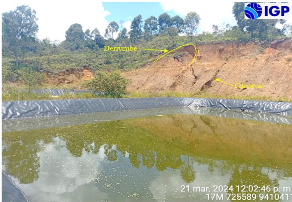
Figura 41.- Derrumbes identificados en los taludes situados en la parte posterior de las lagunas de oxidación, además, se visualizan cárcavas producto de las aguas de escorrentía
