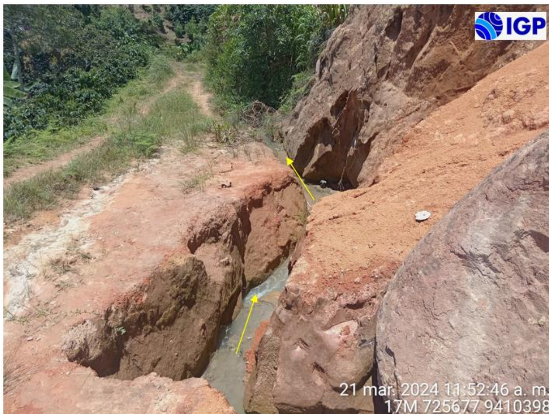
Figura 40.- La evidencia de erosión de laderas en el área de estudio es la generación de una cárcava (flecha amarilla) en la parte baja de las lagunas de oxidación del caserío Buenos Aires
