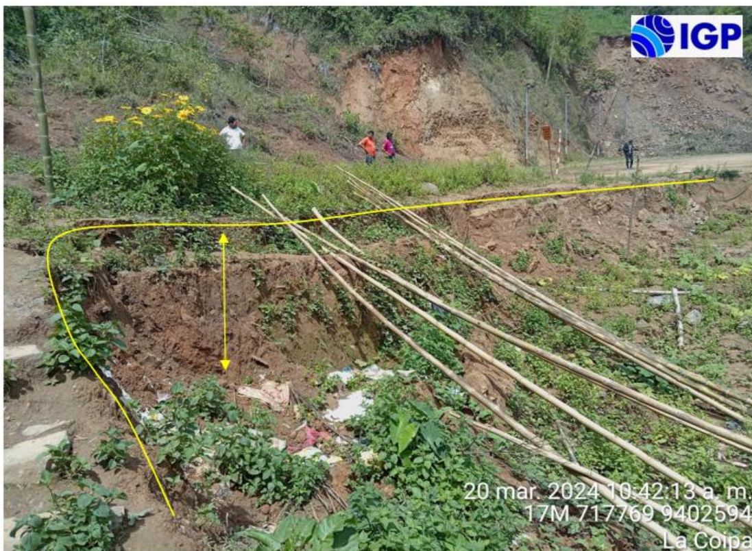
Figura 26.- Escarpe secundario en la parte baja de vía de ingreso al caserío 03 de mayo que presenta aproximadamente 1.50 m de altura
