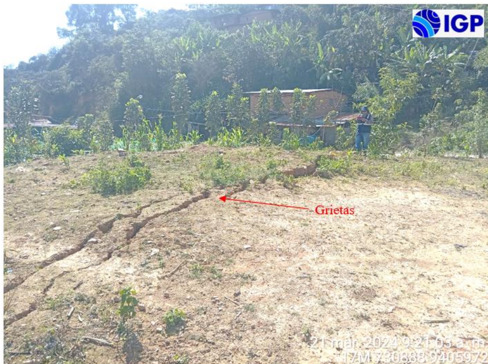
Figura 35.- Grietas en el suelo de 20 m de longitud situadas en la parte baja de la I.E. N 17649 Los Ángeles
