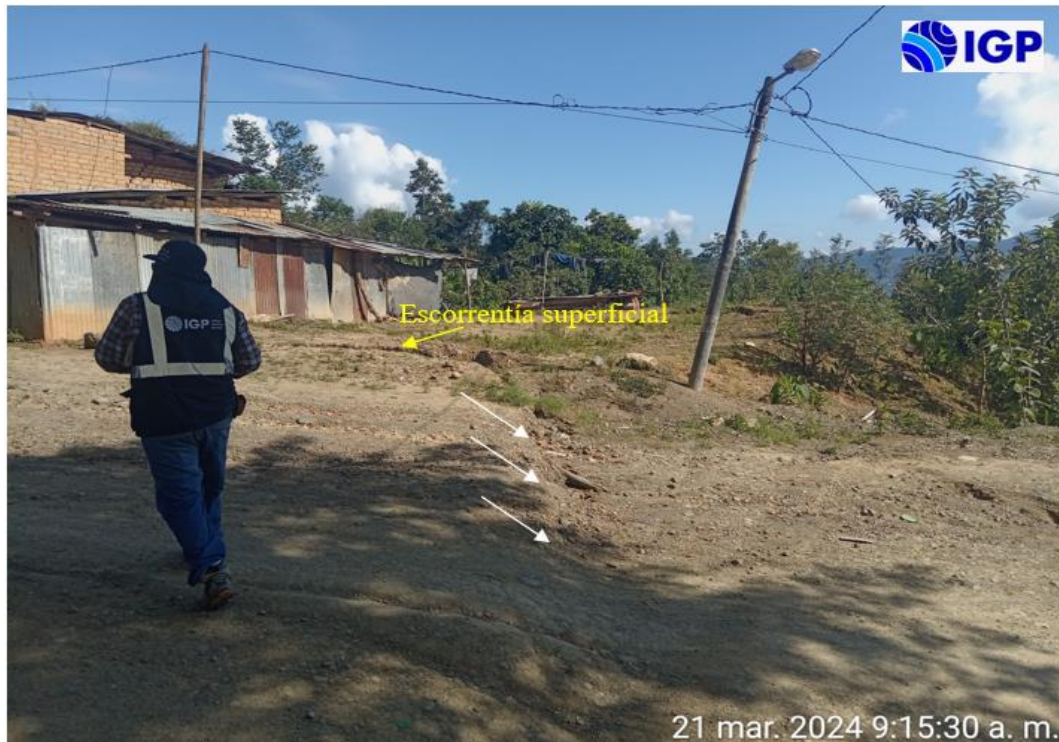
Figura 34.- Vía de acceso principal al caserío Los Ángeles (parte baja de I.E. N° 17649) ubicada sobre área inestable (deslizamiento), como evidencia se aprecia asentamiento del suelo de aproximadamente 0.30 m, poste inclinado y presencia de agua de escorrentía generada en las viviendas del sector que contribuye a la saturación del suelo
