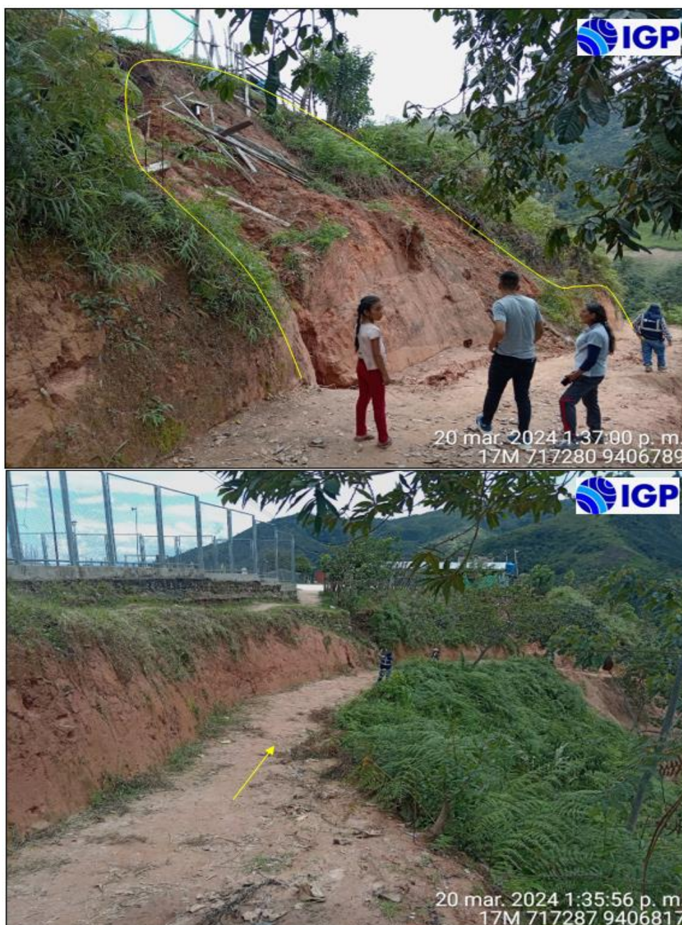
Figura 29.- La imagen superior muestra el derrumbe situado en las inmediaciones del cerco perimétrico de la institución educativa inicial N° 1238 y en la imagen inferior se aprecia talud diseñado para la construcción de vía de acceso (línea amarilla) que presenta pendiente vertical y está conformado por arcilla.
