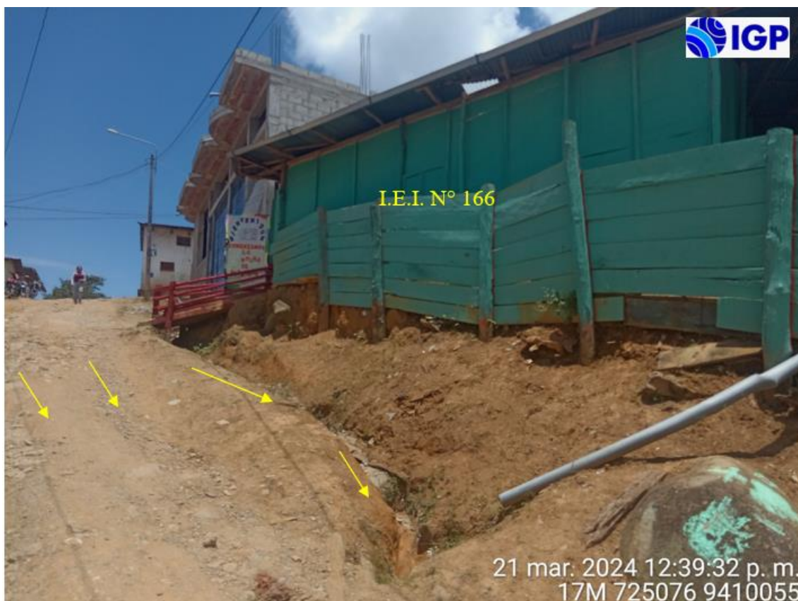
Figura 39.- Erosión de laderas frente a la puerta de acceso principal a la I.E.I N° 166, como evidencia se ha reconocido cárcavas (flechas amarillas) en la calle y zanja de drenaje para evacuación pluvial
