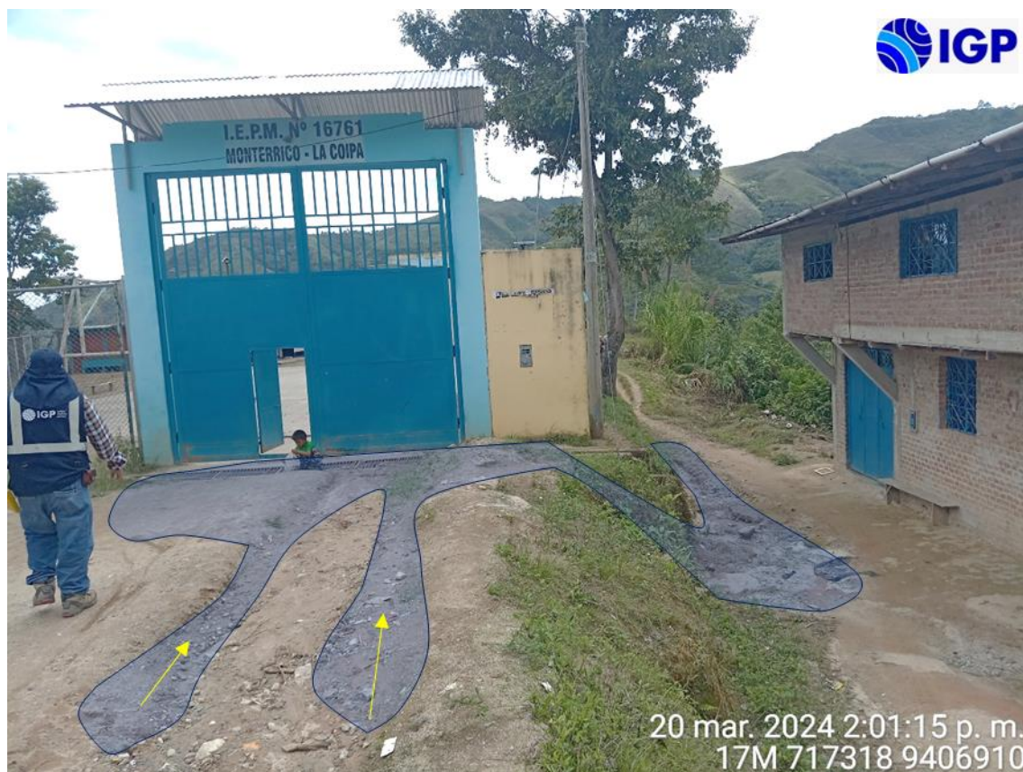
Figura 31.- Área susceptible a inundaciones pluviales en las inmediaciones del portón de ingreso a la I.E. N°16761 debido a la ocurrencia de precipitaciones pluviales intensas
