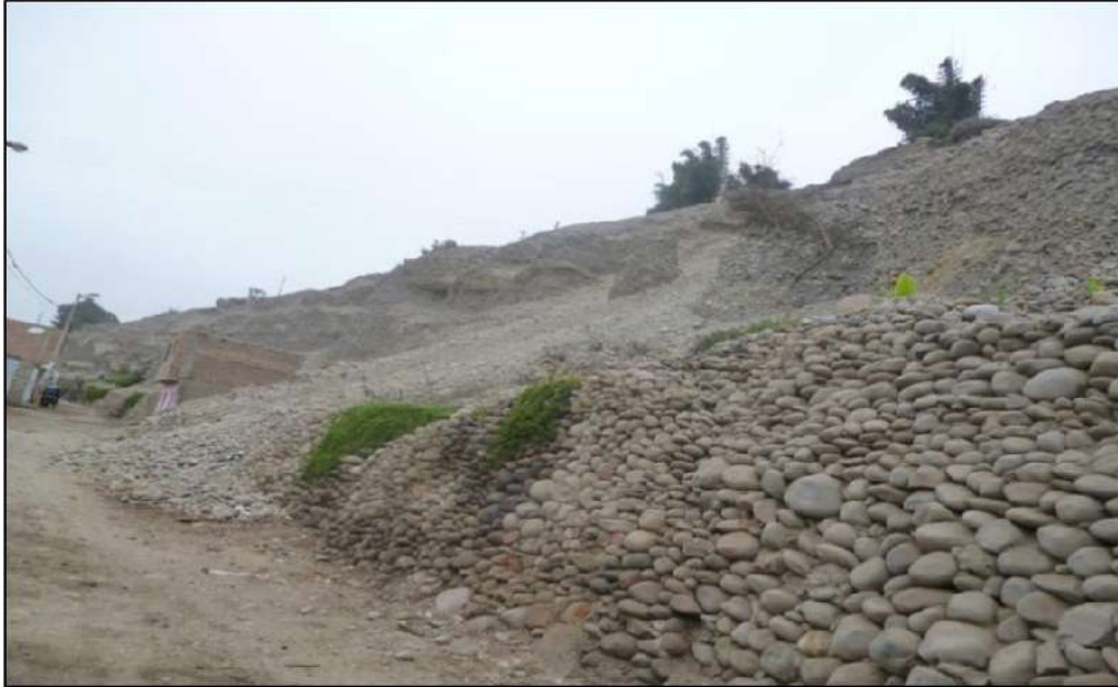
Figura 41: Derrumbre ubicado en el A.H. Las Palmas de Bolívar. La intervención antrópica agrava la estabilidad del talud conformado por gravas redondeadas. Mapa geodinámico para la ciudad de Barranca
