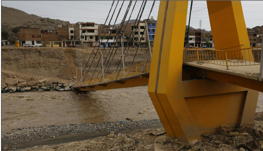
Lima 16/03/2017. El incremento del caudal del río Rímac causó daños en varios puentes. En la imagen se observa el puente Talavera (puente de la solidaridad) que no tenía muchos años de haber sido inaugurado por la Municipalidad de Lima (Fuente: Diario El Comercio).
