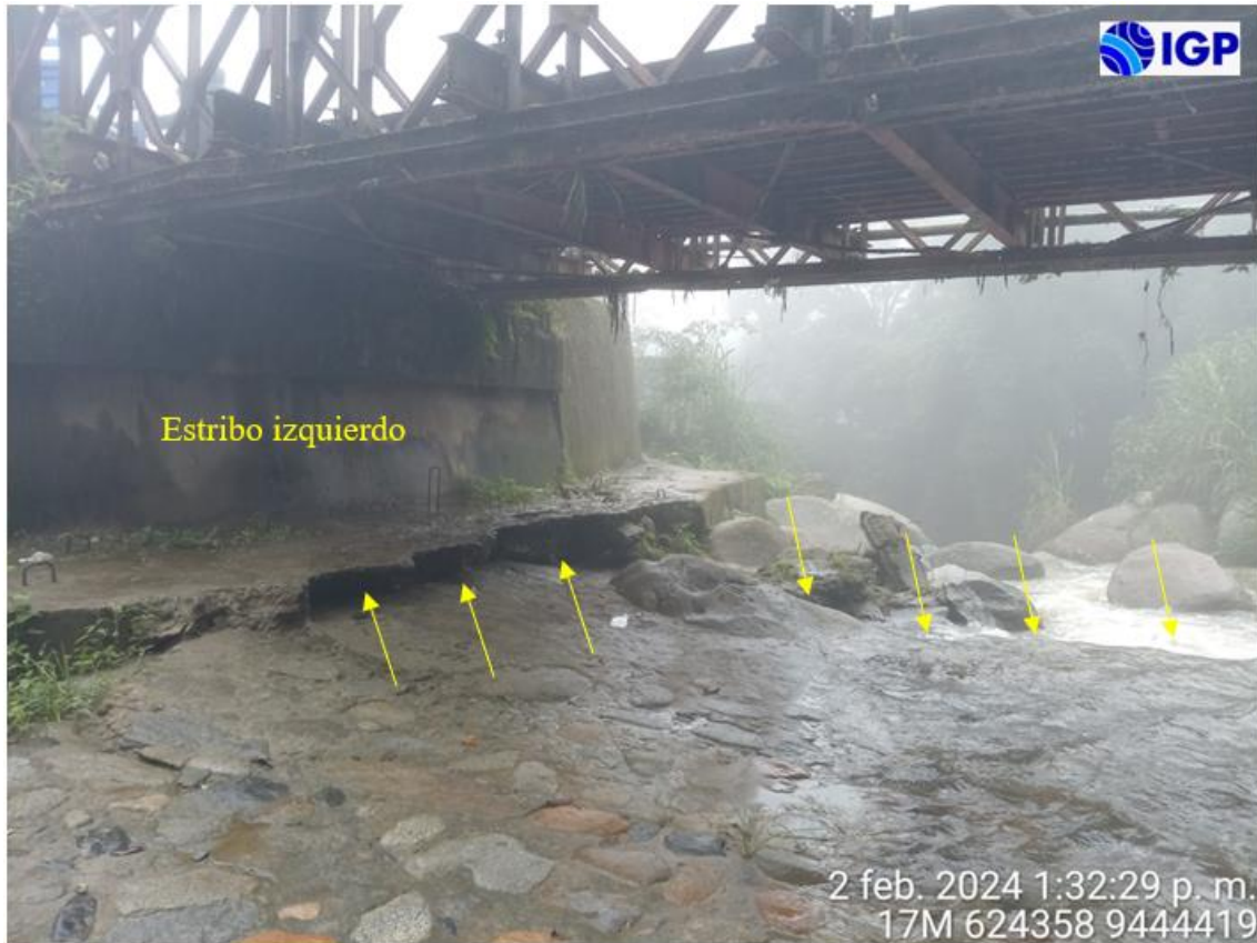
Figura 14.- Erosión fluvial (flechas amarillas) en el cauce del río Santo Domingo que podría afectar el estribo izquierdo del puente modular ubicado en el sector El Chorro
