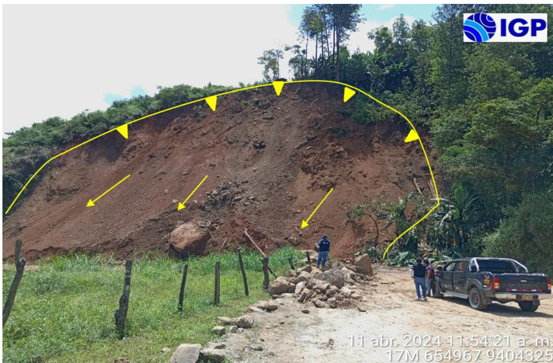
Figura 16.- Deslizamiento del tipo retrogresivo reconocido en las inmediaciones del sector La Paccha que podría afectar un tramo de 59 m de la vía Canchaque – Huancabamba
