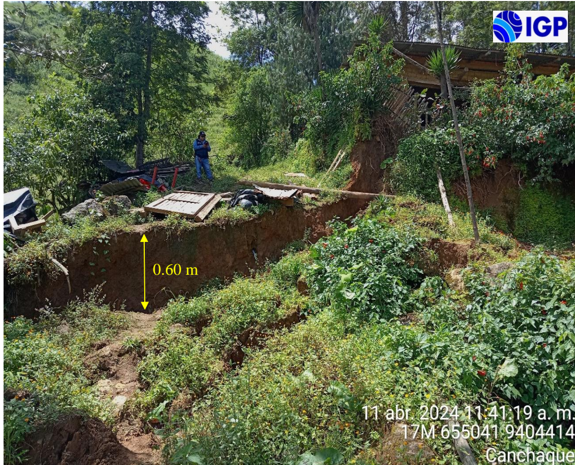
Figura 17.- Asentamiento diferencial del suelo en la parte superior de la cabeza del deslizamiento generado por la escorrentía del agua
