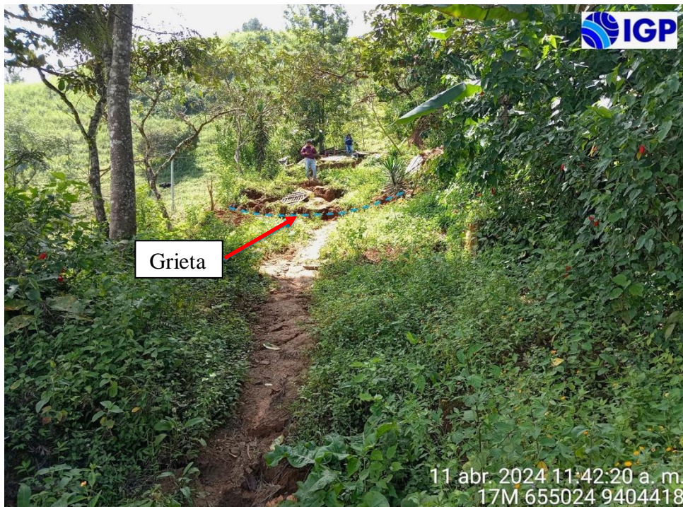
Figura 8.- Vista de ladera de montaña sobre la cual se asientan viviendas del sector Paccha. El terreno se presenta inclinado, conformado por suelos de cobertura y presencia de grietas (línea roja)
