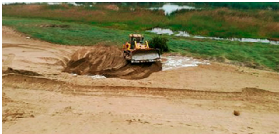
Figura 2. Cargador frontal del GORE Lima en acción para frenar la presencia de invasiones en la zona limítrofe del humedal El Paraíso.
