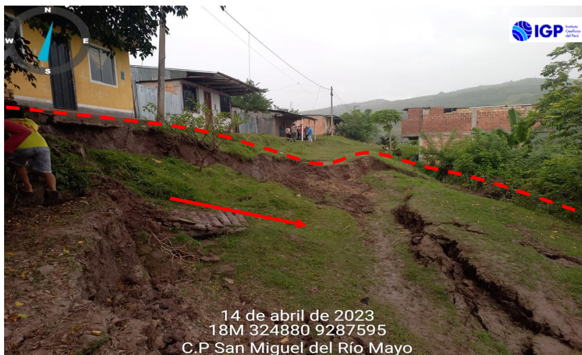
Figura 16.- Zona de arranque del deslizamiento en dirección noroeste – sureste (flecha roja), afectando las viviendas asentadas ladera abajo, con grietas en diferentes direcciones con aberturas de 0.35 m y profundidad de 1.40 m
