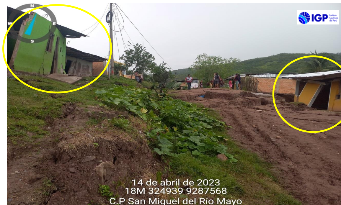
Figura 19.- Viviendas y vías de acceso (calles) afectados a consecuencia del deslizamiento rotacional regresivo, círculo amarillo muestra las viviendas afectadas
