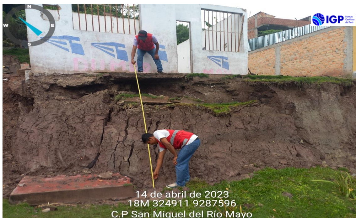
Figura 18.- Escarpa en la parte intermedia del deslizamiento, con salto de 2.90 m, en dirección noroeste – sureste, afectando las calles y viviendas de la zona
