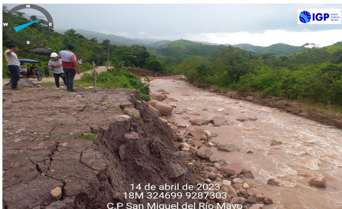
Figura 27.- Derrumbes de talud y colapso parcial de 180 m aproximadamente, de la trocha carrozable que une San Miguel del Río Mayo con Panjuy.
