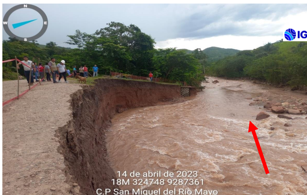
Figura 26.- Erosión fluvial en la margen izquierda de la quebrada Mishquiyacu, afectando la trocha carrozable que une los poblados de San Miguel del Río Mayo - Panjuy
