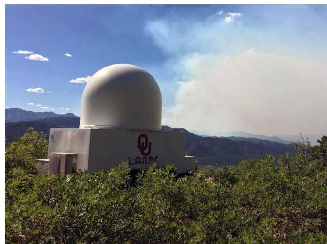
Radar meteorológico PX-1000, instalado en la sierra de Lima (cerro Suche).
