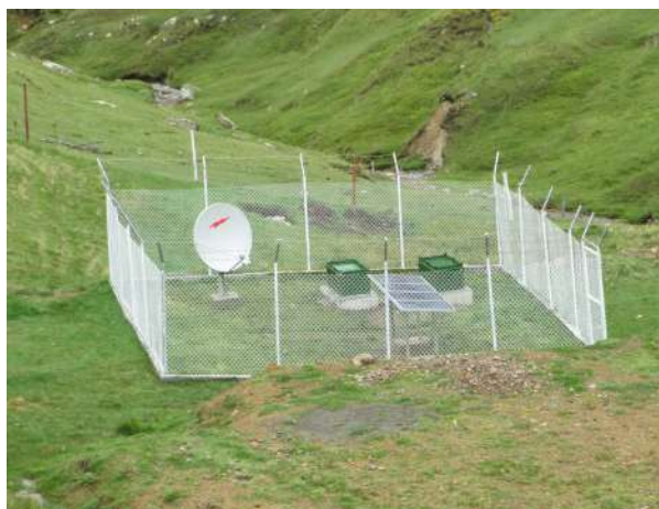
Estación Yanacachi de la Red Sísmica Satelital para la Alerta Temprana de Tsunamis (Redssat).
