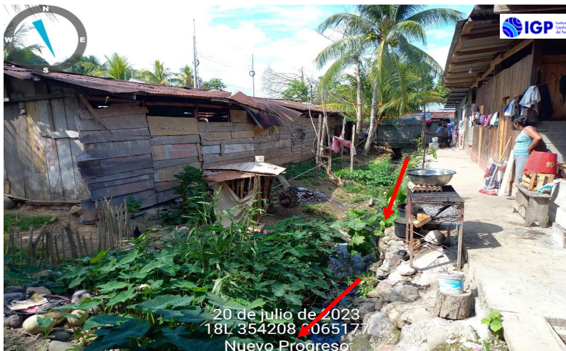
Figura 19.- El canal pasa por las viviendas y en épocas de precipitaciones sobrepasa su capacidad y se desborda afectando las viviendas aledañas en el jirón Pedro Ruiz Gallo. Las flechas indican la dirección del flujo
