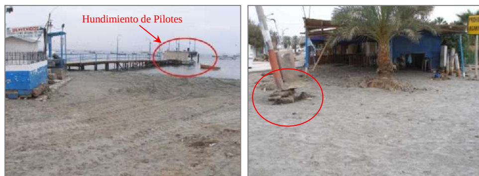
Figura 2.23. Socavamiento de los cimientos en muelles y estructuras tras el tsunami del 15 de Agosto de 2007 (Ica - Perú)
