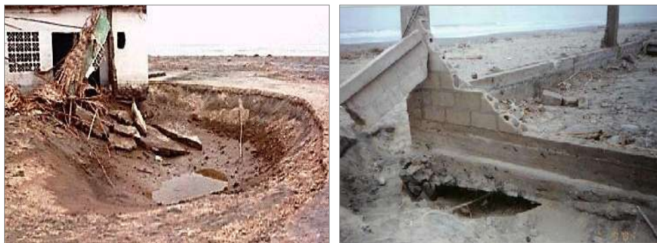
Figura 2.22. Socavamiento de los cimientos de viviendas tras el tsunami del 23 de Junio de 2001 (Camaná - Perú).
