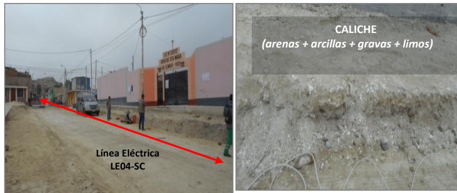
Figura 21: Presencia de caliche en la línea LE04-SC.
