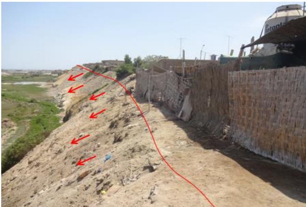
Figura 32: Zona susceptible a desprendimientos de suelos y clastos de gravas (línea roja) ante la ocurrencia de sismos.
