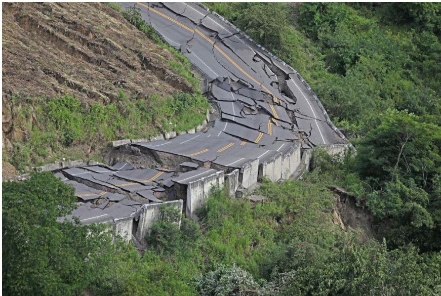
Figura 9: Licuación de suelos en carretera Bagua Grande y Pedro Ruiz (Fuente ANDINA/Prensa)
