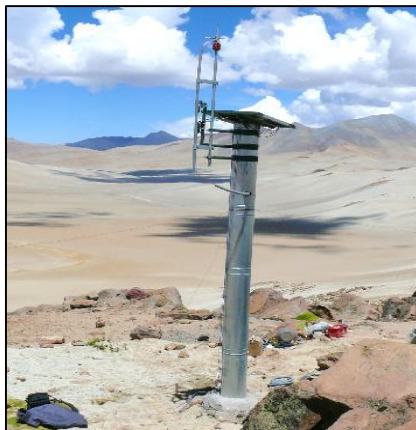
Figura 0.2 Estación sísmica telemétrica para el monitoreo en tiempo real del volcán Ticsani.
