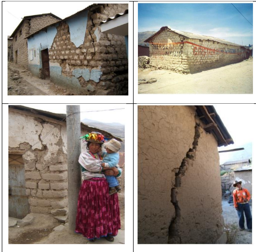
Figura 0.2 Imágenes que muestran los daños ocasionados en la localidad de Calacoa por el sismo de magnitud 5.3 ML ocurrido el 01 de octubre de 2005.
