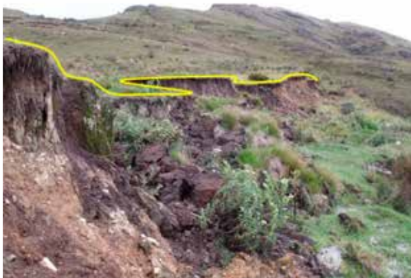
Foto 6. Escarpa principal del deslizamiento Yanacolpa mes de marzo 2013, cota 3800m aprox (ver Figura 3).
