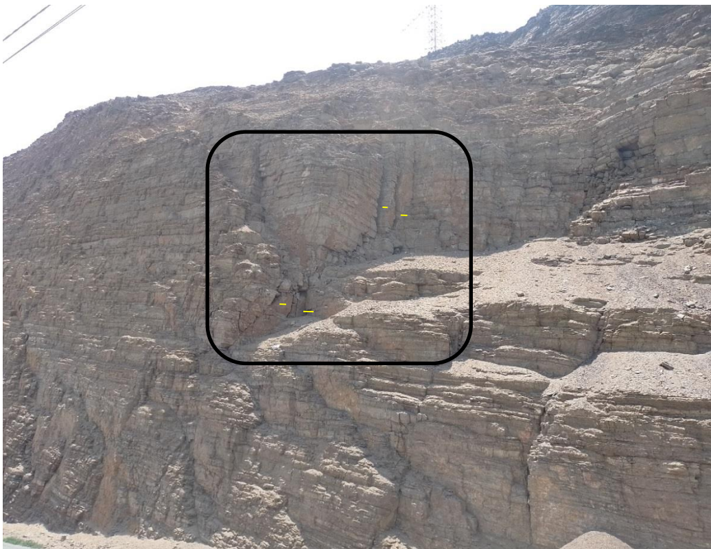
Figura 10.- Punto crítico, zona susceptible a caída de rocas, estrato rocoso meteorizado y fracturado espaciamiento de 0.20m entre bloques (líneas amarillas). Referencia punto 4 de Tabla 1.
