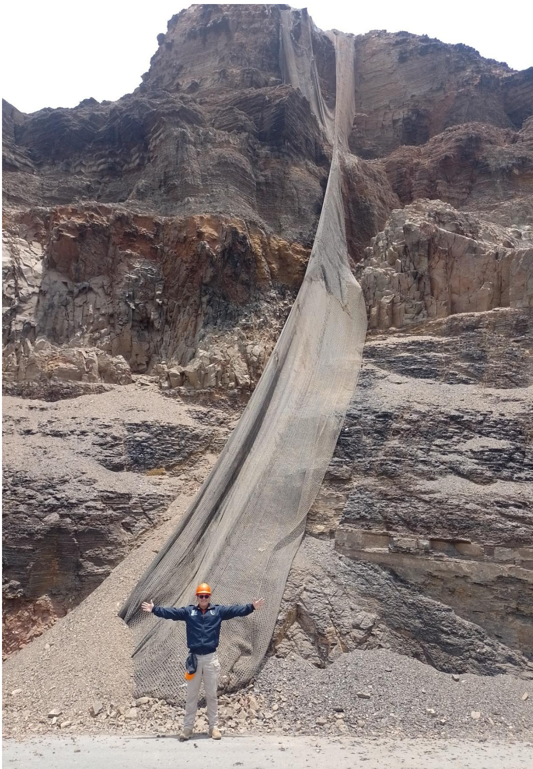
Figura 13.- Punto crítico por caída de rocas, evento suscitado el 01 de noviembre del 2023.
