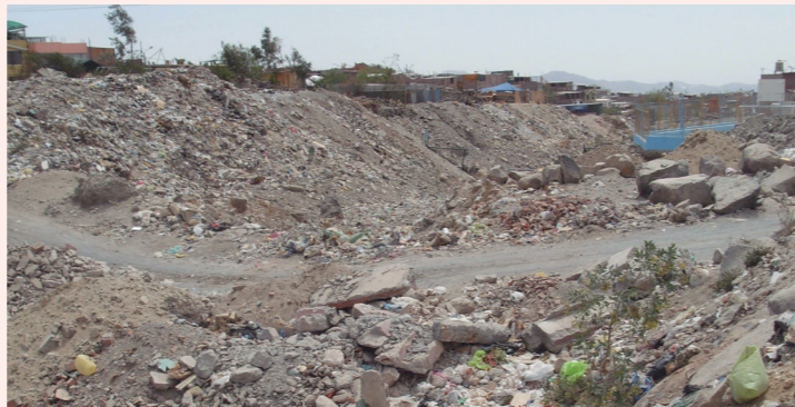
QUEBRADA HUARANGAL: Cauce obstruido por desmontes y basura donde se ha habilitado una carretera de conexión distrital.
