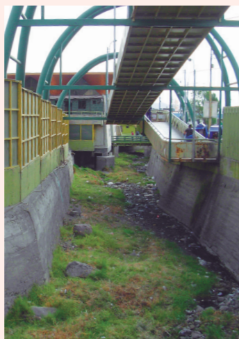
QUEBRADA LOS INCAS: Construcción de una columna del terminal terrestre de Arequipa en el cauce de la quebrada.
