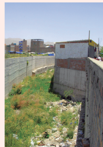
QUEBRADA LOS INCAS: Estrangulamiento del cauce de la quebrada por la construcción de muros y paredes.
