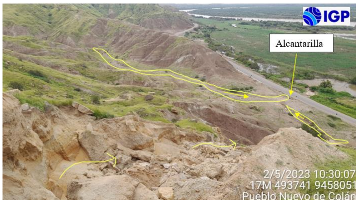
Figura 65.- Zonas susceptibles a flujos de lodos (polígonos amarillos) en la parte baja del canal de coronación que drena las aguas de escorrentía superficial del Tablazo del C.P. San Felipe hacia alcantarilla situada en la vía Costanera, estructura que podría colmatarse
