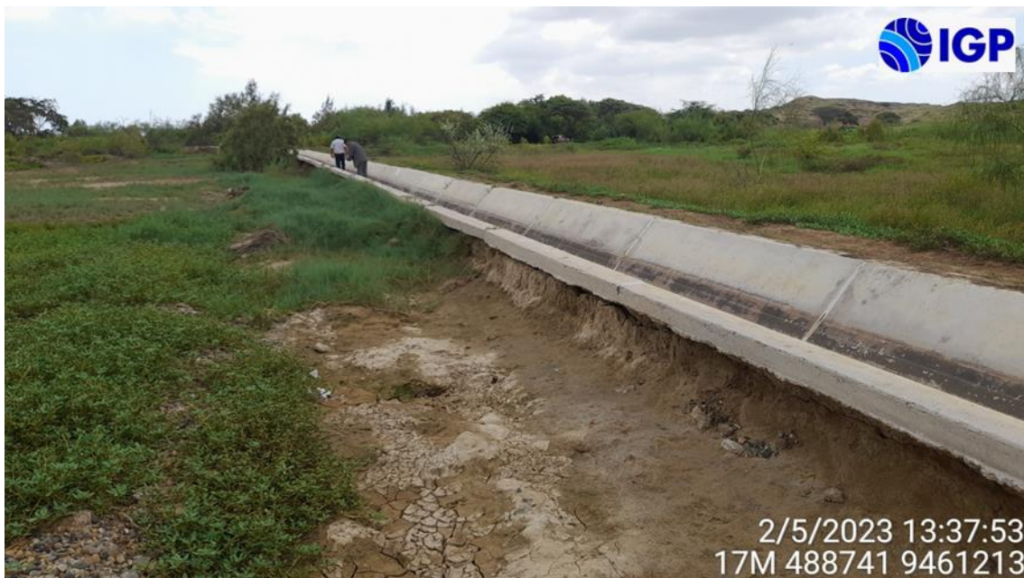
Figura 69.- Inundaciones pluviales contiguas al canal de regadío denominado Los Valencia, además, se ha originado la erosión lateral del canal y asentamiento de las losas de concreto debido a la saturación del suelo
