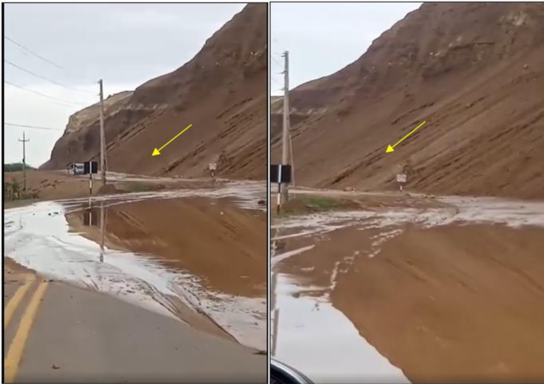
Figura 56.- Derrumbes generados en el cerro Cinchado durante la ocurrencia de precipitaciones en el presente año. La imagen de la izquierda muestra la acumulación de los materiales cubriendo el carril derecho de la vía costanera y en la derecha el material inconsolidado
