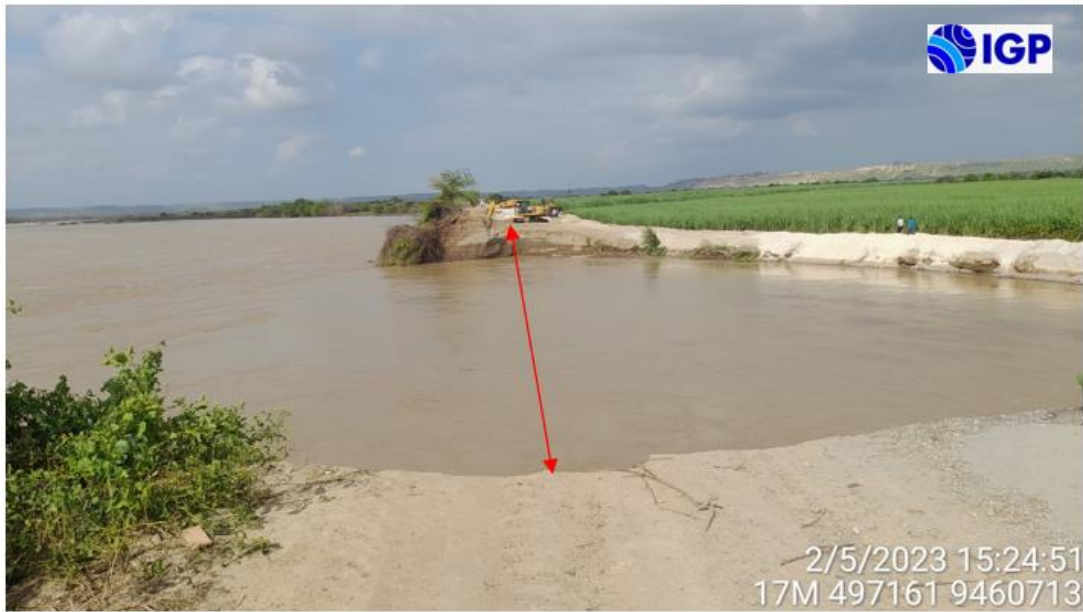
Figura 72.- Colapso de un tramo de 90 m del dique denominado 1020 (flecha roja), producto de la erosión fluvial generada en un meandro del margen izquierdo del río Chira
