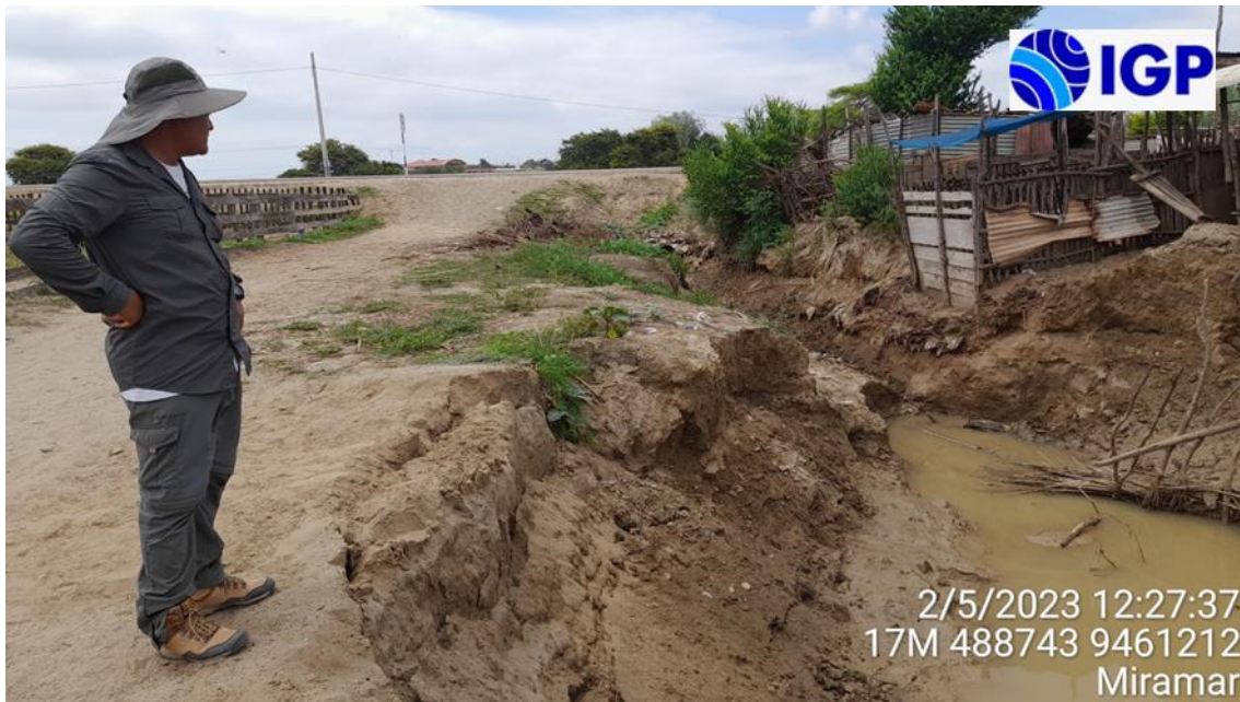
Figura 68.- Zona susceptible a inundaciones pluviales ante la ocurrencia de las precipitaciones pluviales e incremento del volumen de agua del canal denominado Nuto, además, se evidencia erosión lateral en ambos márgenes
