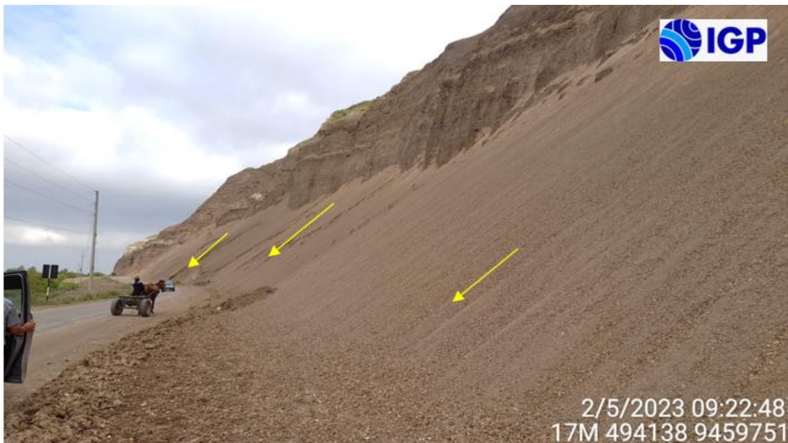
Figura 57.- Derrumbes generados en el cerro Cinchado durante la ocurrencia de precipitaciones debido a la erosión de las rocas del tipo lutitas.
