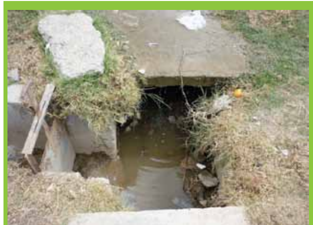
Figura 8. En la imagen se observa claramente la acumulación de barro y la presencia de residuos sólidos de botellas y plásticos, lo que demuestra la falta de mantenimiento en la limpieza de los canales del sistema de drenaje pluvial.
