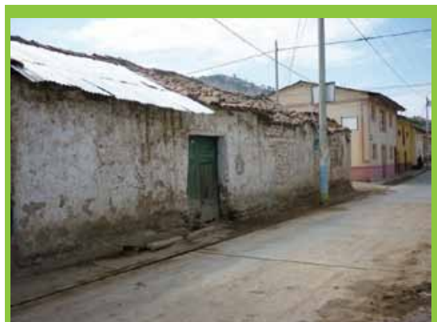
Figura 9. La zona urbana del distrito de Concepción tiene viviendas que podrían encontrarse en riesgo de colapso por la antigüedad de sus infraestructuras.
