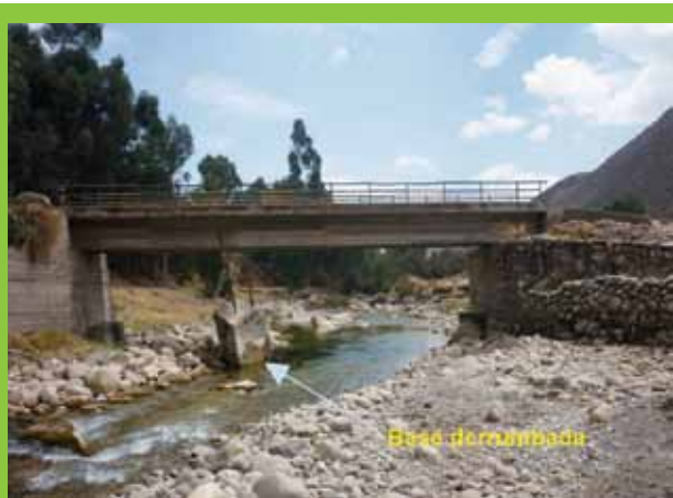
Figura 7. Una de las bases del puente que conecta los barrios de la C. C. de Jarpa, se derrumbó años atrás ante la crecida de las aguas del cauce del río Cunas.
