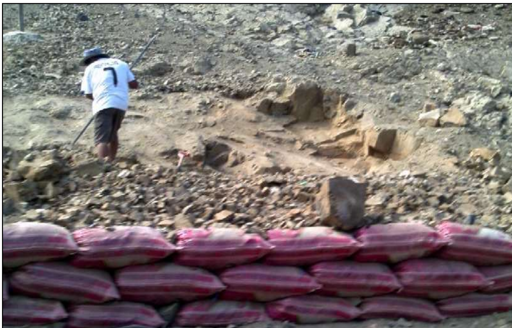
Figura 39: Agrupación de Viviendas Miraflores con presencia de movimientos de masa contenidos con sacos de arena a fin de que no bloquear la carretera de acceso.
